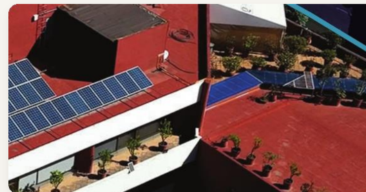
Azotea con paneles solares
